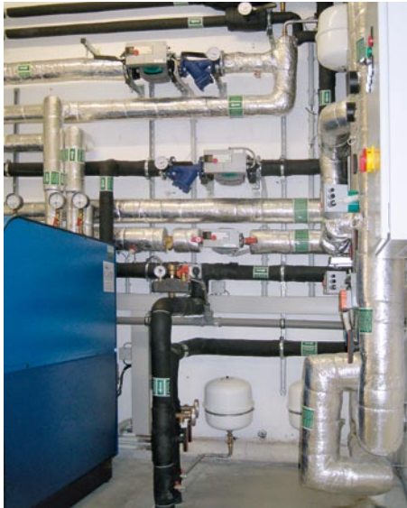
Bild 7: Verrohrung mit den drei Hocheffizienzpumpen und Verbindung in den Keller zum Prozesswasserspeicher
