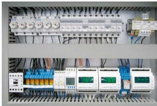
Bild 8: Schaltkasten mit Steuerung und Regelung. Die gesamte Elektroverteilung für Kältemaschinen, Rückkühler, Pumpen und alle Klimageräte, die Pumpen- und Ventilsteuerung, automatische lastabhängige Funktionsumschaltung, Teillaststeuerung für die Slave-Kältemaschine und die Temperaturregelung sind hier enthalten.
