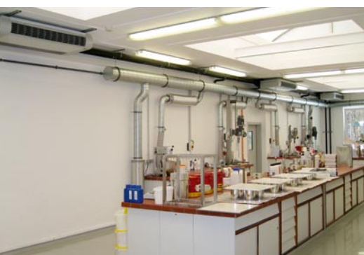
Bild 3: Labor mit Klimakonvektoren
