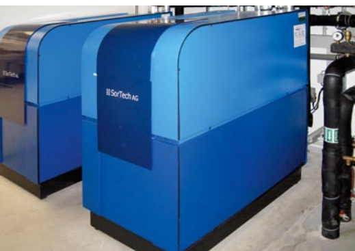
Bild 2: Zwei Adsorptionskältemaschinen mit in Summe 30 kW Nennkälteleistung
