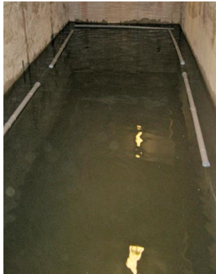
Bild 4: Prozesswasserspeicher im Keller mit an HT-Rohren aufgehängten Edelstahl-Wellschläuchen als Wärmeübertrager
