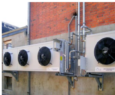
Bild 5: Rückkühler der Adsorptionskältemaschinen mit energiesparenden EC-Ventilatormotoren
